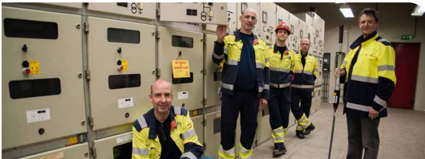
De elektriciens van ARN (vlnr): Wilbert Boerakker, Walter Gommers, Jasper Scheepers, Ferry van Vliet en Stan Vos.
