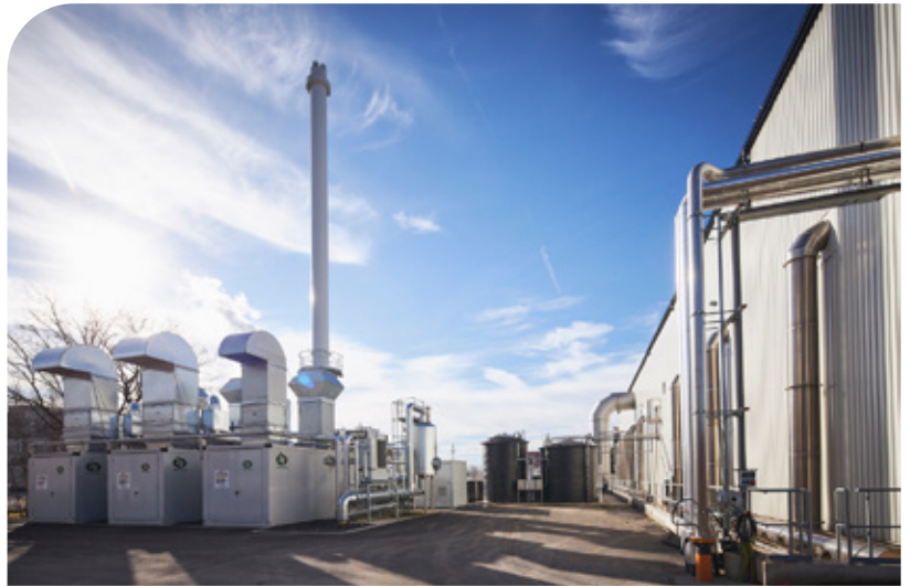
Een installatie voor het winnen van ammoniumsulfaat. (Foto: REMONDIS)
