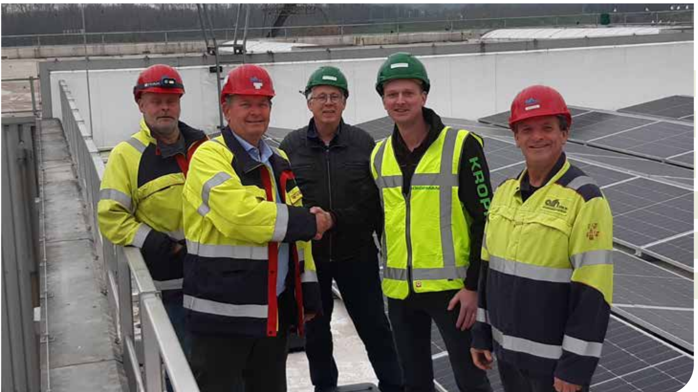
Bij de ingebruikname (vlnr): Henry Cornelissen (facility manager ARN), Rutger Jan Pessers (directeur ARN), Leo Albers en Boy van Haalen (Kropman Installatietechnik) en Stan Vos (electrical engineer ARN).
