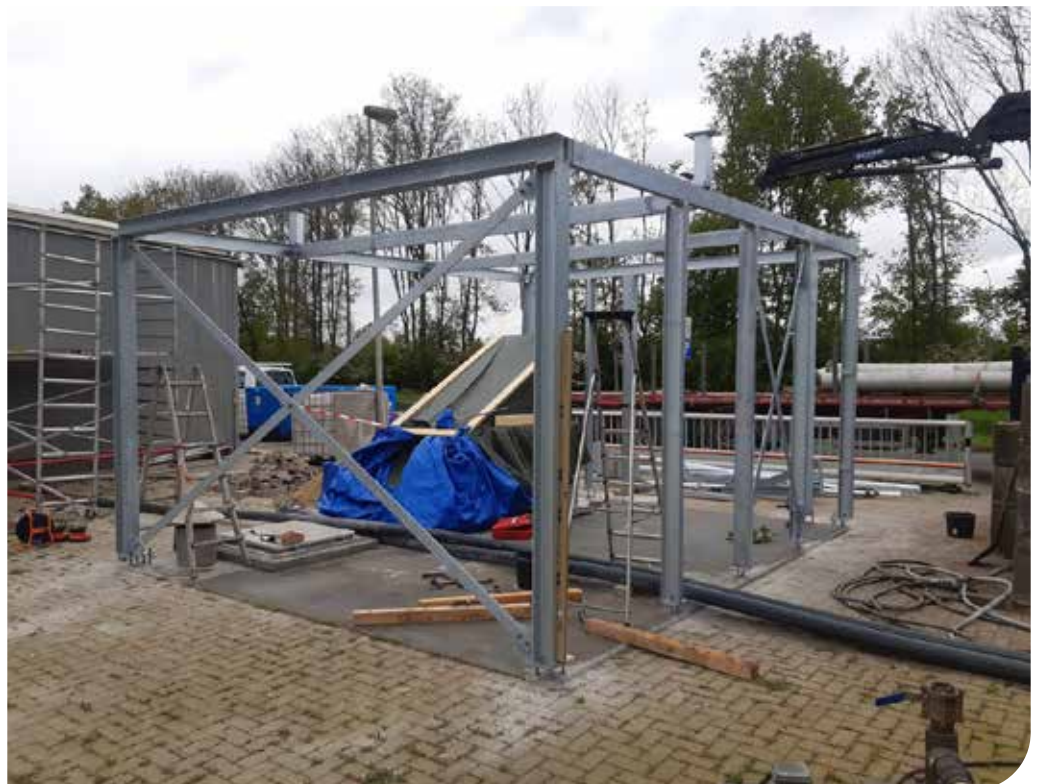
Nieuwbouw van de ruimte voor sturingsapparatuur.
