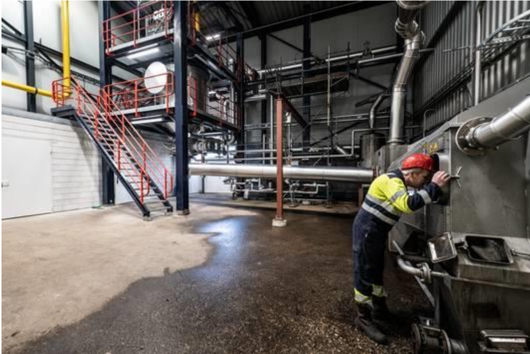
➤ De reactorruimte van de luierverwerkingsinstallatie in Weurt. © Paul Rapp
